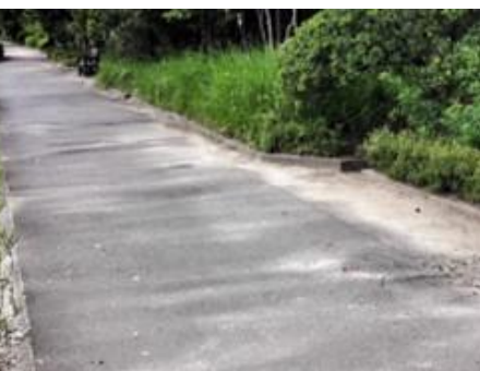
樹木の根により地面が隆起したウ オーキングロード(江端公園周辺) 市の公式LINEの「損傷通報」でも 知らせることができます
